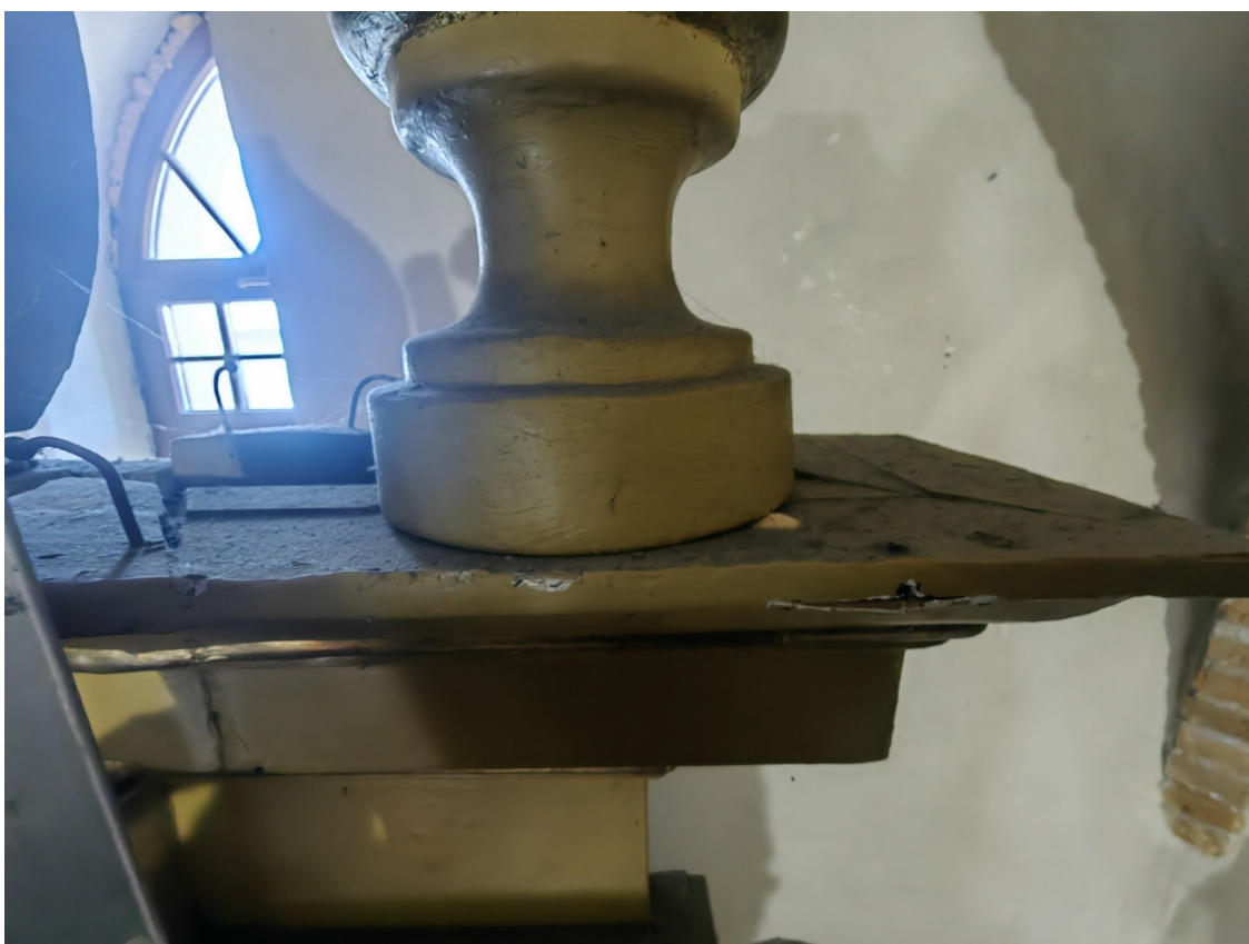
Fot. 12 Warstwa kurzu i brudu na gzymsie oraz uszkodzenia mechaniczne
