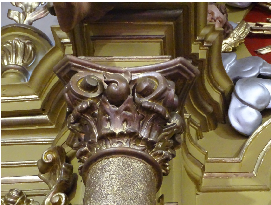
Fot. 6 Zaoksydowany detal architektoniczny
