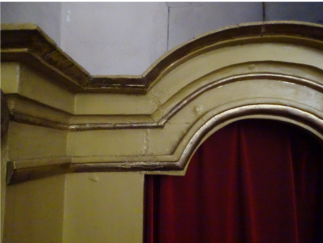
Fot. 4 Ślady po wcześniejszych naprawach i uzupełnieniach oraz uszkodzenia mechaniczne
