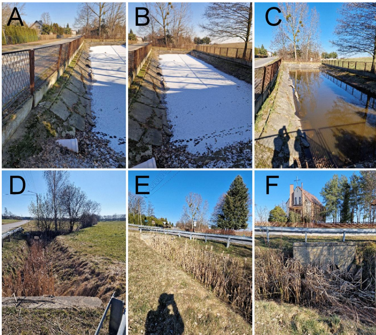
Rys. 15 Zbiornik wodny, przeciwpożarowy w miejscowości Natolin gmina Lipie powiat kłobucki: A - skarpa od strony drogi; B - dno basenu; C - woda w stawie i widoczne uszkodzenia powłok betonowych; D – rów odprowadzający wodę ze zbiornika; E – zarośnięte szuwarami dno rowu; F – ujście wody z przepustu do rowu.
